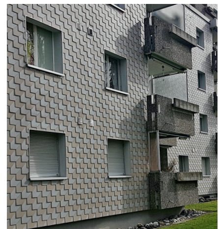
Wohnüberbauung in Weinfelden (6 Wohnblöcke 2000m² mit Eternit-Schindeln). Die dauernd veralgten und verschmutzten Fassaden mussten praktisch jährlich mit grossem Aufwand gereinigt werden!
